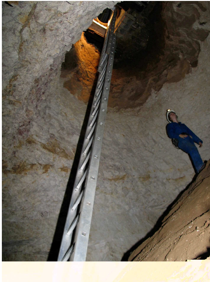
Photo 13 : exemple d'effondrement d'intensité limitée en surface
