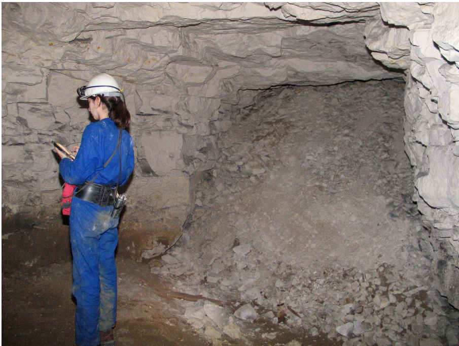
Photo 6 : galerie bloquée par remblais ou éboulis d'ancien effondrement
