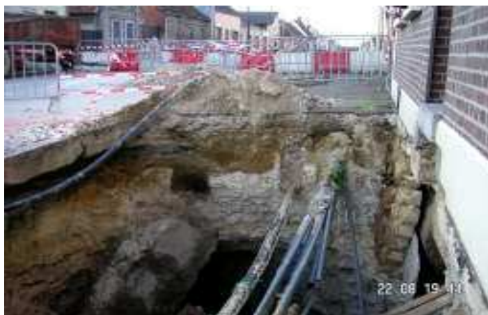
Photo 14 : exemple d'effondrement localisé d'intensité modérée à Esquennoy
